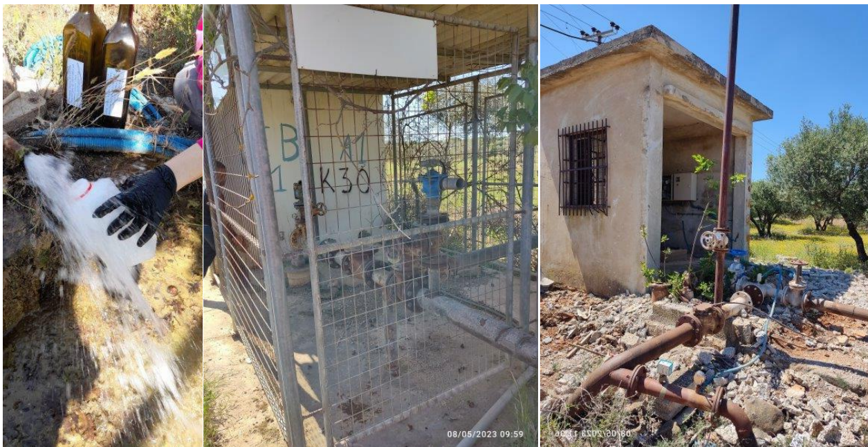
Εικόνα 4.2-18: Δημοτικές γεωτρήσεις GEOT 79, GEOT 69 και GEOT 25
