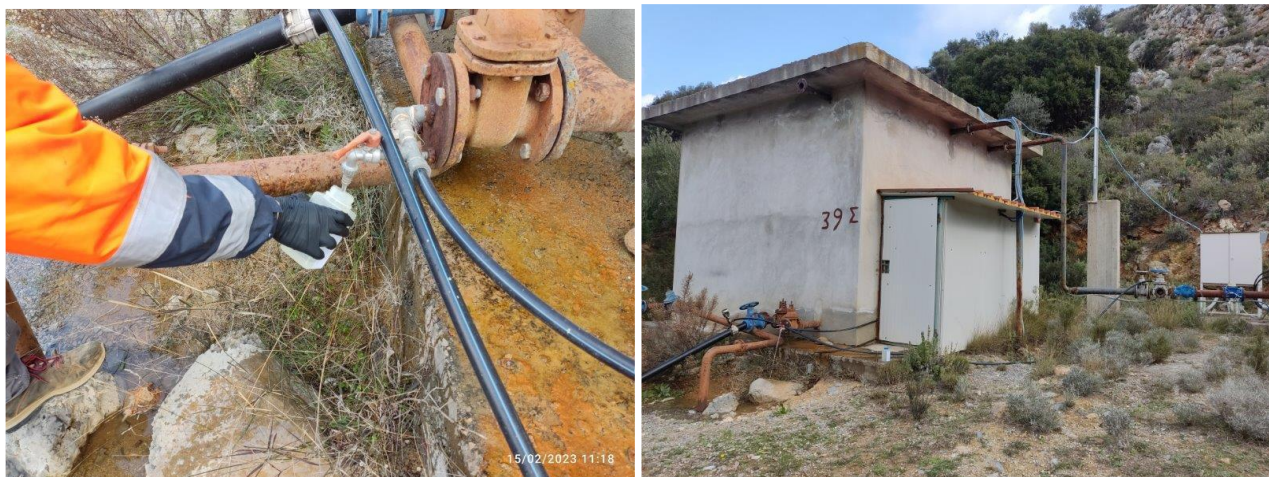
Εικόνα 4.2-23: Δημοτική Γεώτρηση - Πηγή θέση ΚΟΞΑΡΗ ΠΗΓΗ
