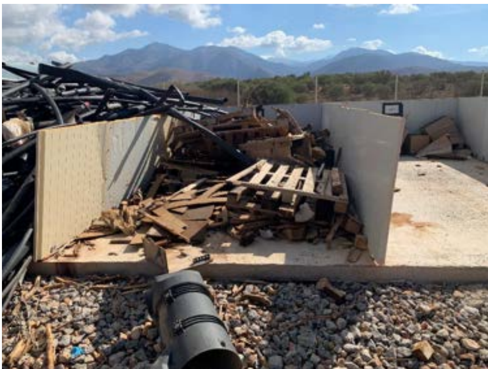
Εικόνα 23: Χώρος προσωρινής αποθήκευσης μη επικίνδυνων αποβλήτων – Ξύλο
