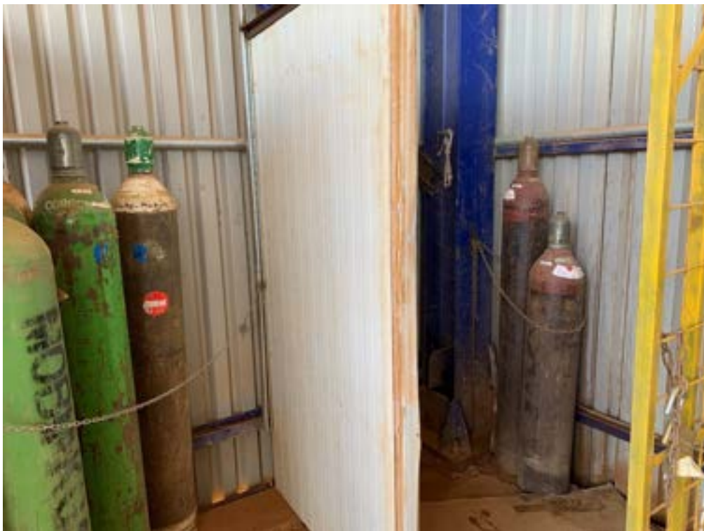
Εικόνα 4.6-6: Αποθήκευση φιαλών αέρα υπό πίεση
