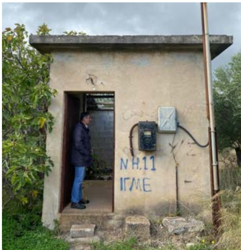
Εικόνα 4.2-10: Δημοτική γεώτρηση GEOT 25 – Σταθμός παρακολούθησης ΕΔΠ EL13101393
