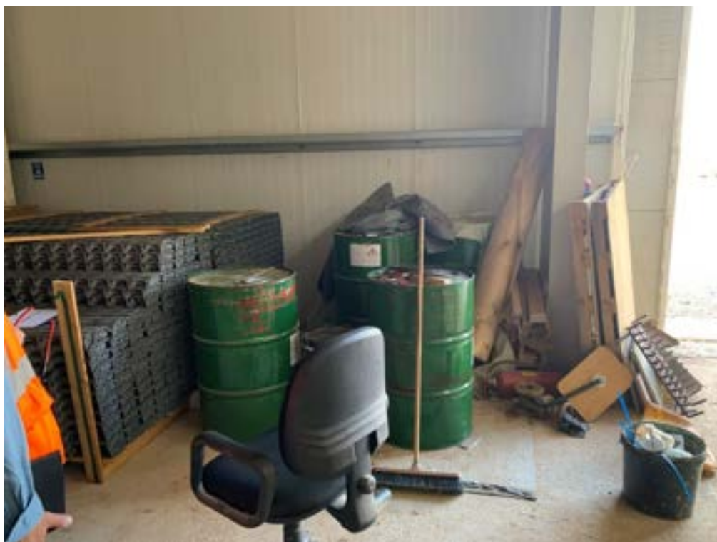
Εικόνα 4.6-14: Αποθήκευση Επικίνδυνων Υλικών εντός της αποθήκης υλικών εντός εργοταξιακού χώρου – Ασφαλτικά Γαλακτώματα
